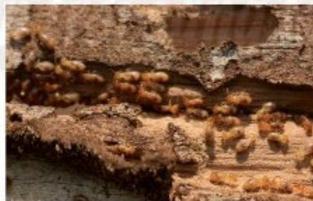
Mối phá hoại công trình xây dựng
