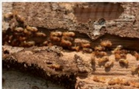
Mối phá hoại công trình xây dựng
