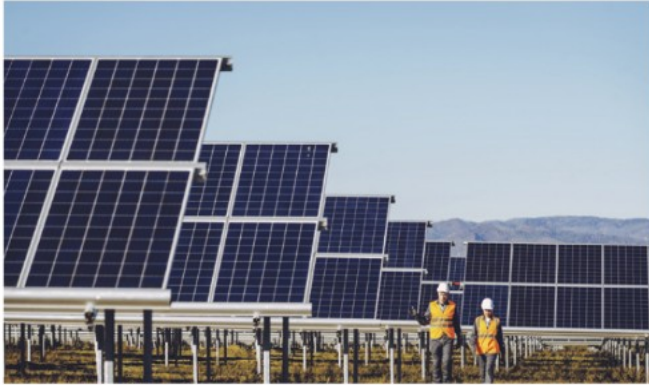
a) Nhà máy điện mặt trời
