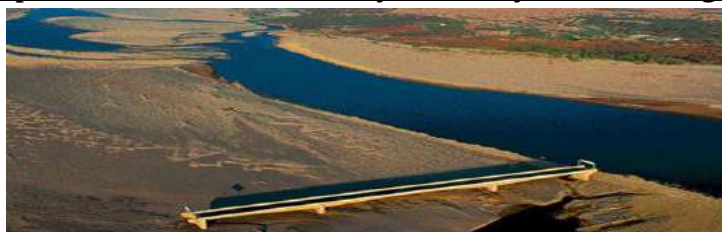
Cầu Puente Sol Naciente sau cơn bão Mitch - Ảnh: Team N Power
