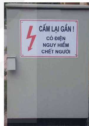
Hình 17.7. Biển cảnh báo an toàn điện
