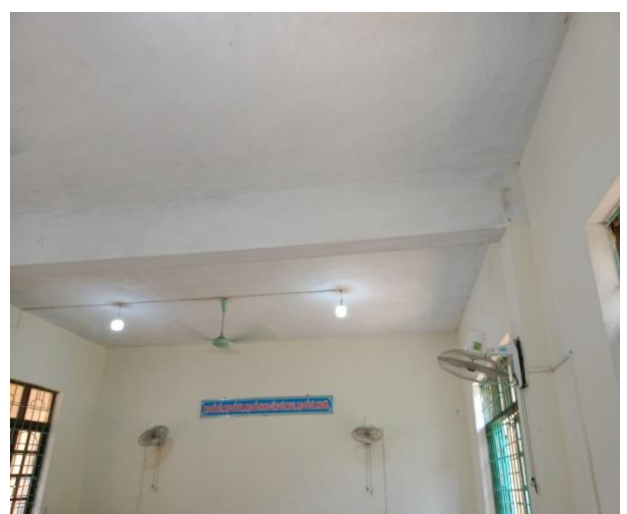
Hệ thống điện, quạt an toàn
