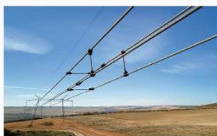
▲ Hình 16.2. Dây dẫn truyền tải điện
