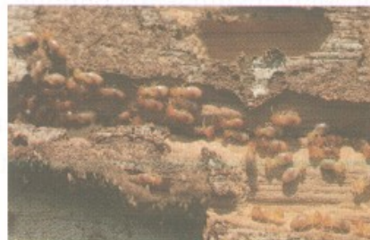
Mối phá hoại công trình xây dựng
